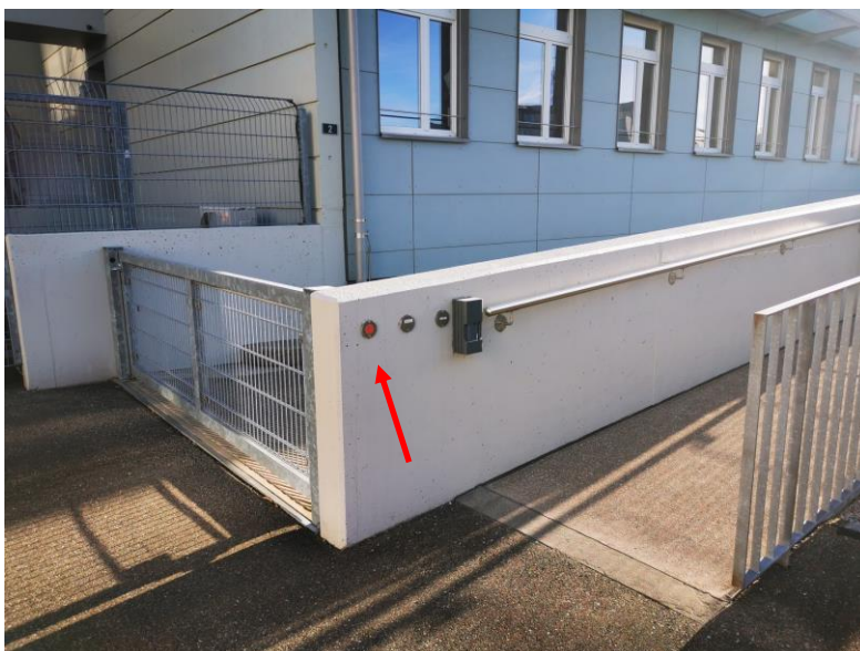
Beispiel Standort Schlüsselrohr
